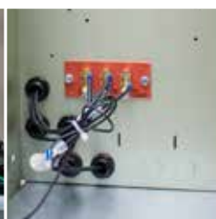
Tablilla de conexiones
