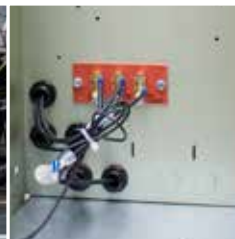
Tablilla de conexiones
