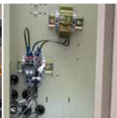
Tablilla de conexiones
