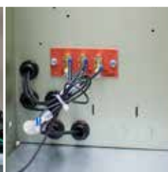
Tablilla de conexiones
