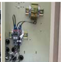
Tablilla de conexiones
