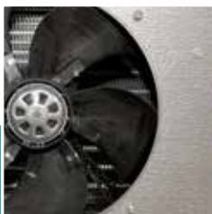
Motor y ventilador
