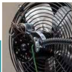
Motor y ventilador
