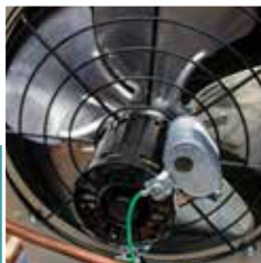
Motor y ventilador
