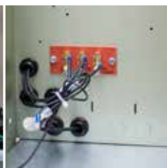
Tablilla de conexiones
