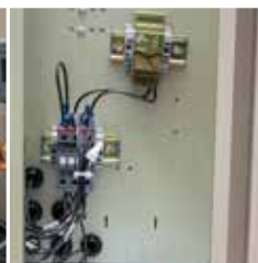
Tablilla de conexiones
