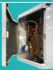
Conexiones y Serpentin
