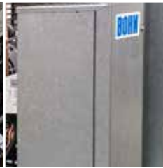
Tablilla de conexiones
