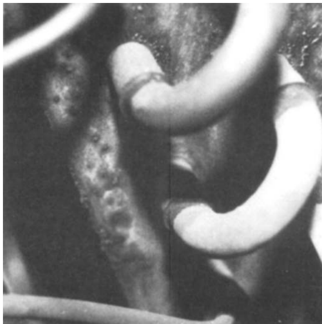
La fotografía presentada arriba muestra los efectos de la corrosión sobre una de las cabeceras del serpentín
